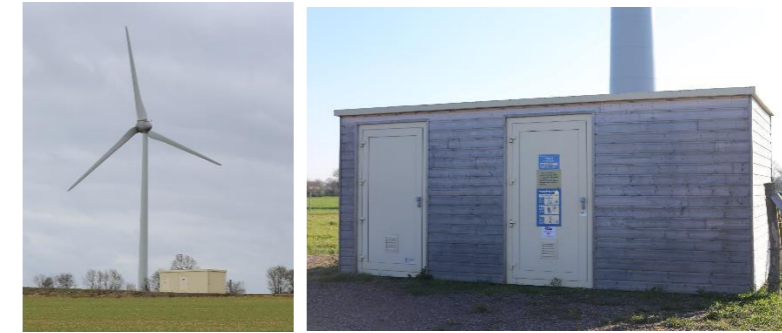
Figure 13 : Exemples de poste de livraison électrique
